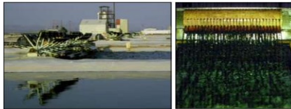
Figure 25 (de gauche à droite) : Système de pompe, Système de tamis 12 .
