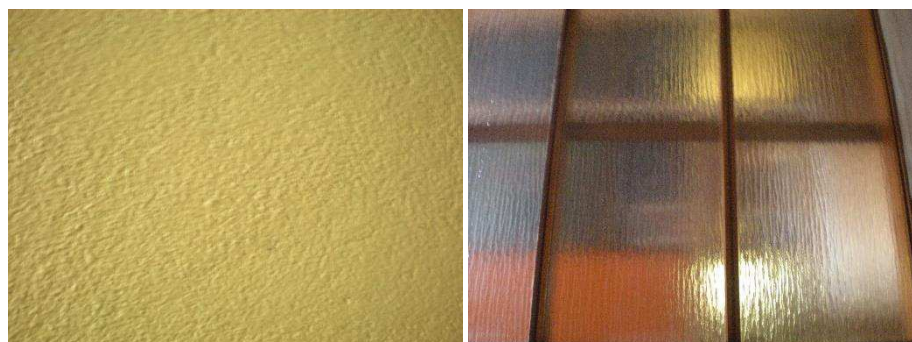
Figure 23 - A gauche, mur du 1er étage du bâtiment B, à droite, fenêtre de la cage d'escalier du bâtiment A
