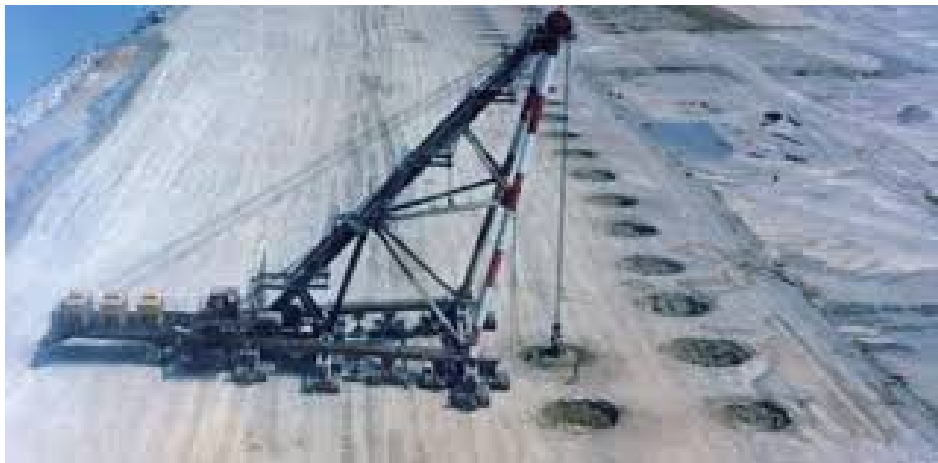
FIGURE 2 – Compaction dynamique de haute énergie (4000Tm) pendant les travaux d'extension de l'aéroport de Nice [Varaksin, Chu, Klotz, Mengé,2009]
