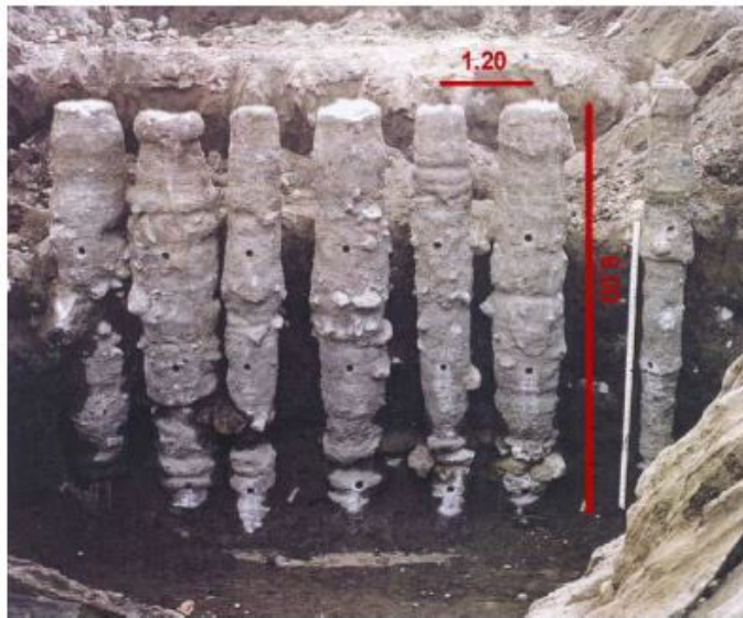
FIGURE 23 – Variation de diamètre typique pour des colonnes en jet grouting [Denies, Huybrechts, 2013]
