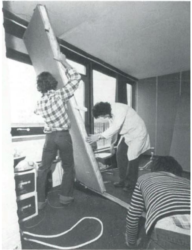
Illustration 23: Une cloison mobile en cours de montage. (c) Atelier d'Architecture Simone et Lucien Kroll.
