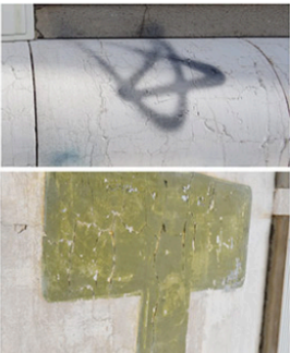
Graffiti sur pierre massive / lettrage HELIOS // à restaurer
