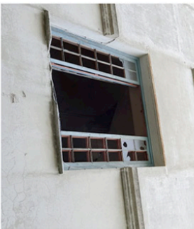
Appui pierre massive à reprendre ponctuellement // à restaurer
