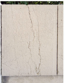
Pierre massive de chaînage Fissurations ponctuelles // à restaurer
