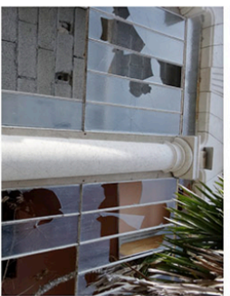
Colonnes pierre massive // à restaurer
