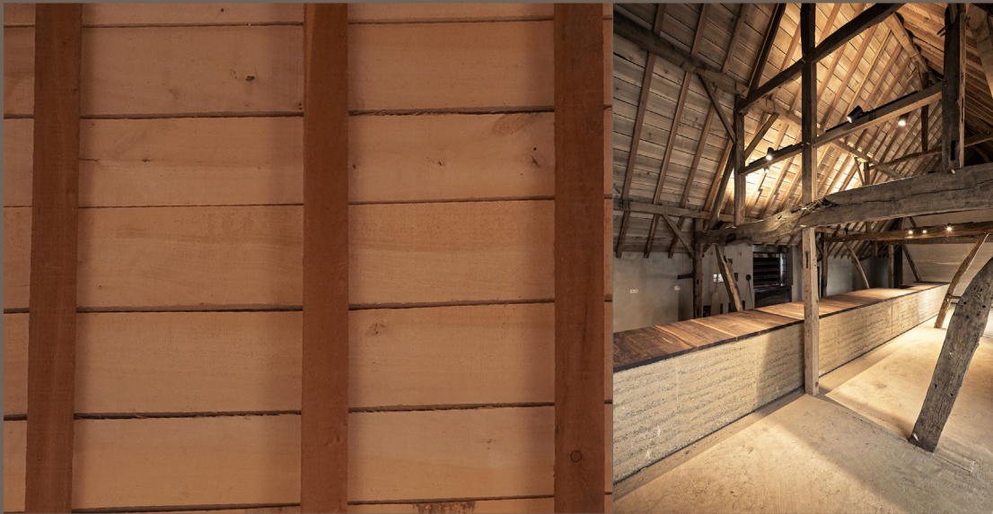
Figure 61. Sous toiture de la BKRK Bakery . Crédit Louise Rompen (gauche) et Luc Daelemans (droite)
