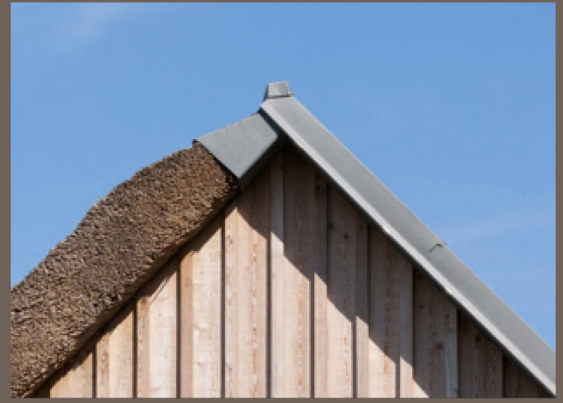
Figure 43. Faîtage métallique . Le Clos des fées du bureau CoBe . Crédit Luc Boegly
