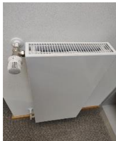
Figure 14: Radiateur à vannes thermostatiques
