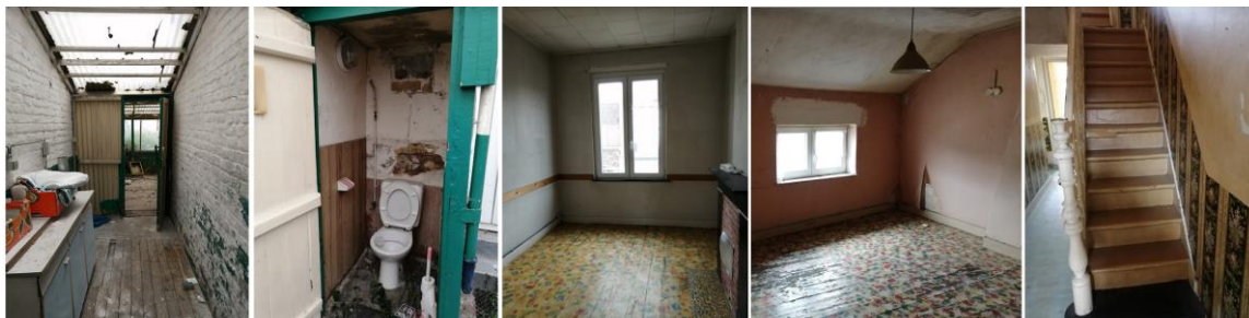
Figure 7-2 : De gauche à droite – espace de cuisine vétuste dans la véranda, w.c. extérieurs vétustes, chambre à transformer en salle de bain, chambre avec éclairage naturel insuffisant, escalier à conserver et éventuellement rafraichir.
