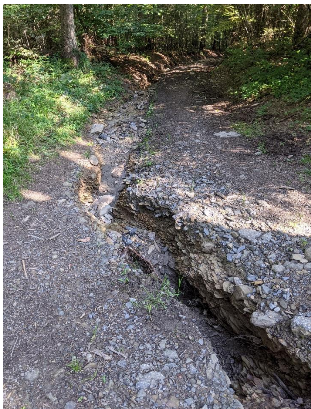
Figure 23. Sillon creusé par l'eau sur un chemin en pente
