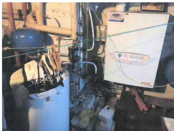
Figure 3-8 : Photo des installations de chauffage et de production d'ECS
