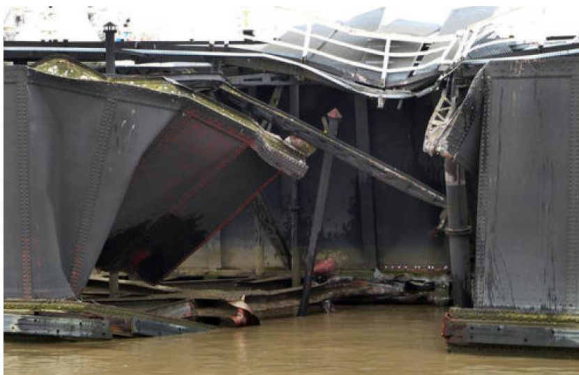
FIGURE 1.1 – Exemple d'accident - Canal de Kiel (Allemagne)
