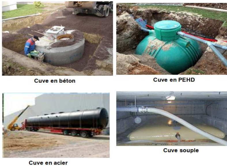
Figure 11 Différents types de cuves de stockage de l'eau de pluie. Source (Belmeziti, 2012)
