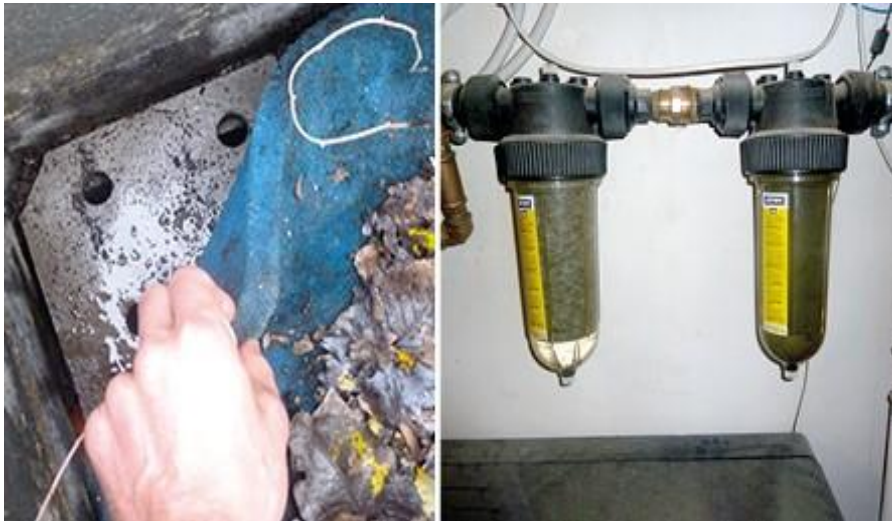
Figure 35: les filtres eau de pluie. A gauche préfiltre, au droite filtre à 20 micros Source ecoconso.be
