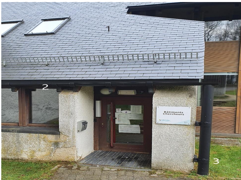
Figure 17 : Système de collecte des eaux de pluie avec 1 : eau de pluie qui ruissèle du toit, 2 : elle glisse vers les gouttières, 3 : elle tombe vers les descentes de gouttière via le tuyau qui relie la gouttière à la citerne
