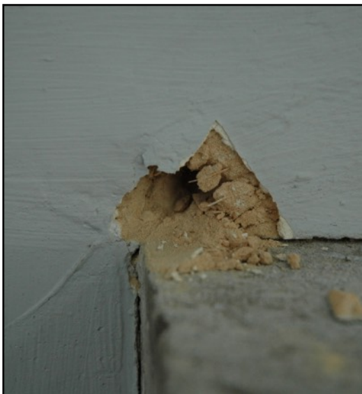
Fig.91: Plâtre dégradé laissant apercevoir un creux, photographie personnelle, 06/10/2021.
