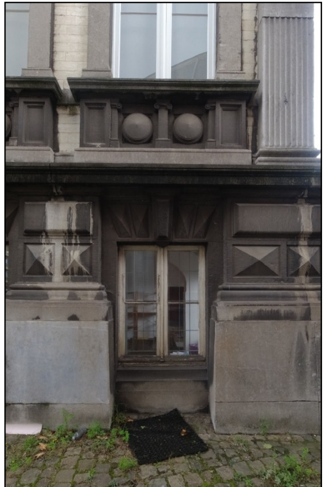
Fig.55 : Partie basse d'une travée du pignon 0/01, photographie personnelle, 06/10/2021.
