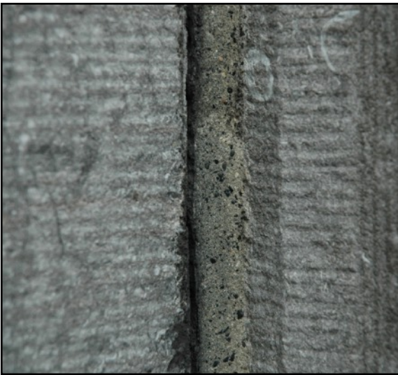
Fig.67 : Scories visibles dans les joints de maçonnerie, photographie personnelle, 08/10/2021.
