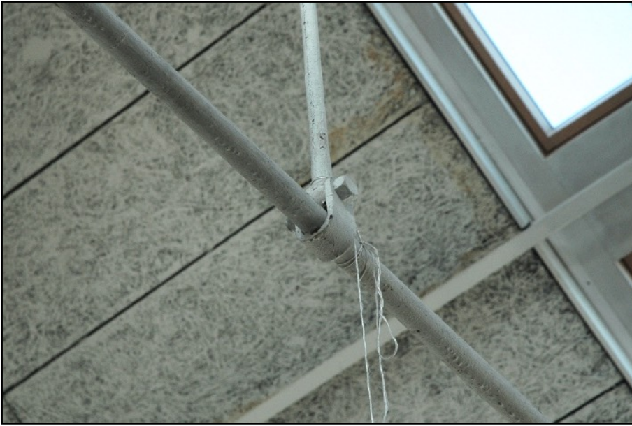
Fig.79 : Assemblage du poinçon et de l'entrait d'une des fermes du grand laboratoire, photographie personnelle, 06/10/2021.
