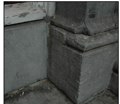
Fig.63 : Pied d'une baie de la façade 0/03. Taille manuelle (à droite) et taille mécanique d'un apport postérieur (à gauche), photographie personnelle, 08/10/2021.
