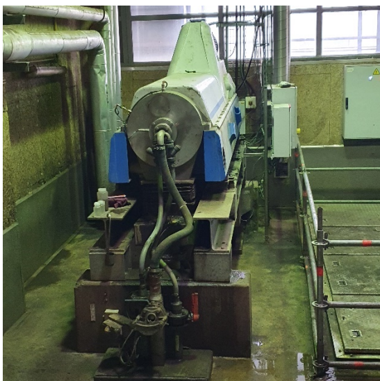
Figure 20: Centrifugeuse 2 de l'usine
