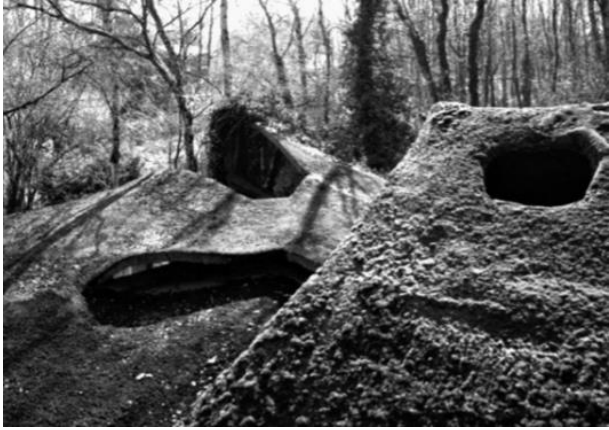
Figure 86 : Patine naturelle du béton méconnaissable sous sa couche de mousse verte.
