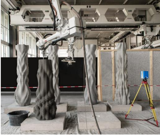
Figure 84 : Mélanie W., Des robots impriment en 3D des colonnes en béton sans coffrage, 17 juillet 2019.
