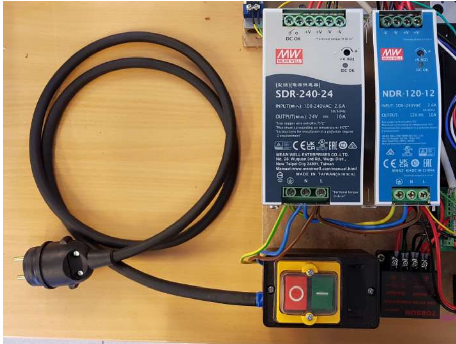
FIGURE 7.15 – Bloc d'alimentations 12 et 24 VDC
