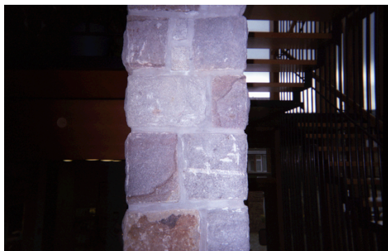
FIGURE 44 – PHOTO PRISE PAR MARCEL : MUR
