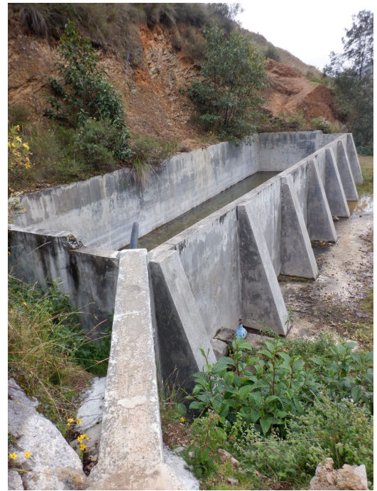
(b) Photo : réservoir.
