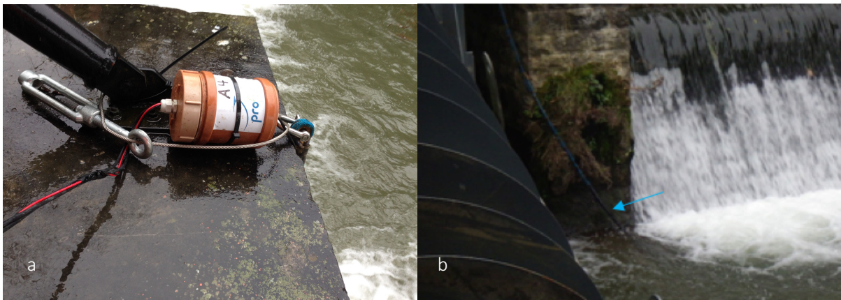
Figure 13 : (a) Boîtier d'accord de l'antenne de télémétrie – (b) antenne radio immergée au pied du barrage
