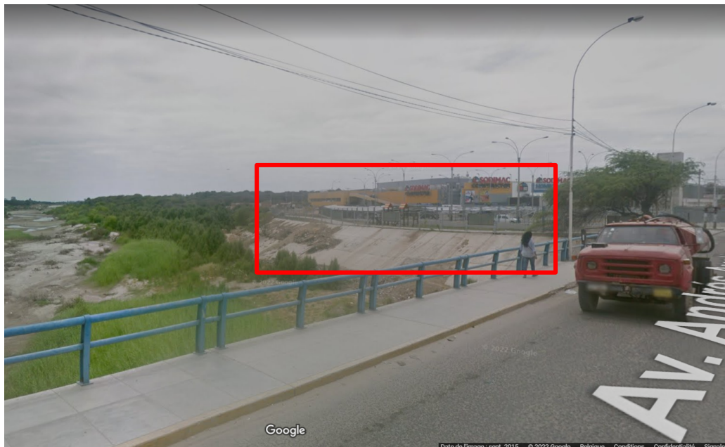
Figure 11: Absence de murs de soutènement sur la rive gauche de la rivière Piura, en amont du pont Cáceres. Source : Google Maps (2015)
