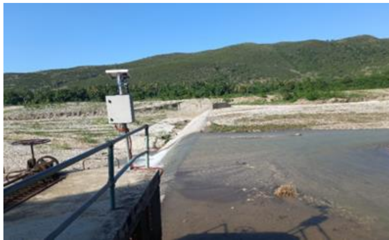
Figure 27. Système d'alerte défectueux sur la rivière Momance
