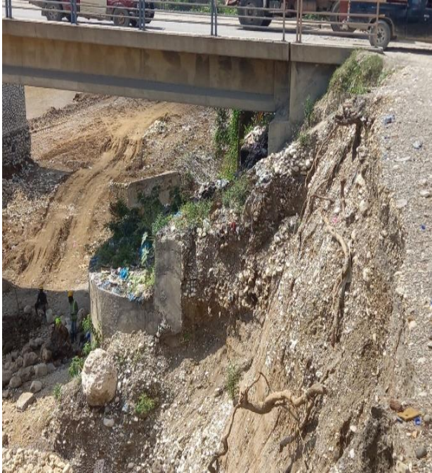
A-Attaque du pont par l'inondation
