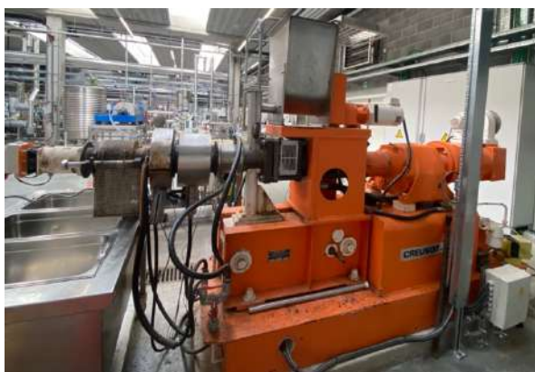
Figure 72 : Extrudeuse bivis (Creuset-Loire).
