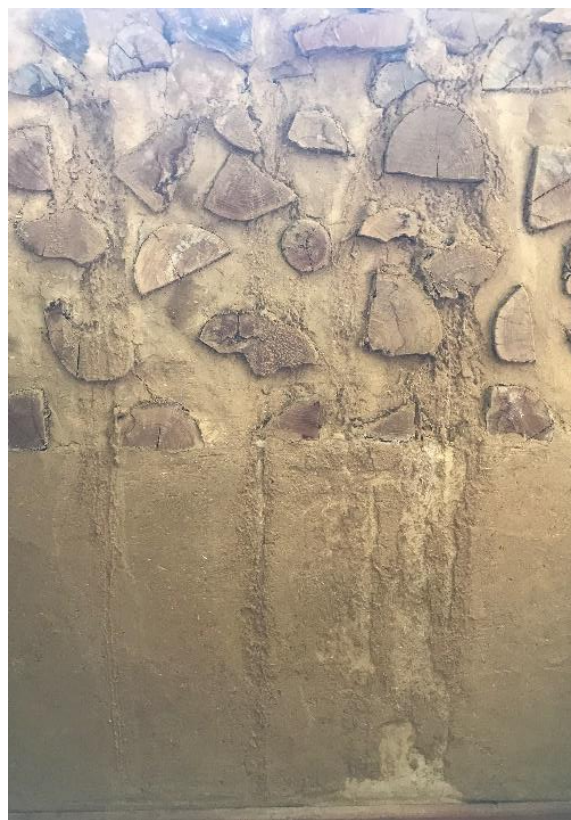
Illustration 30 : Traces d'infiltrations d'eau
