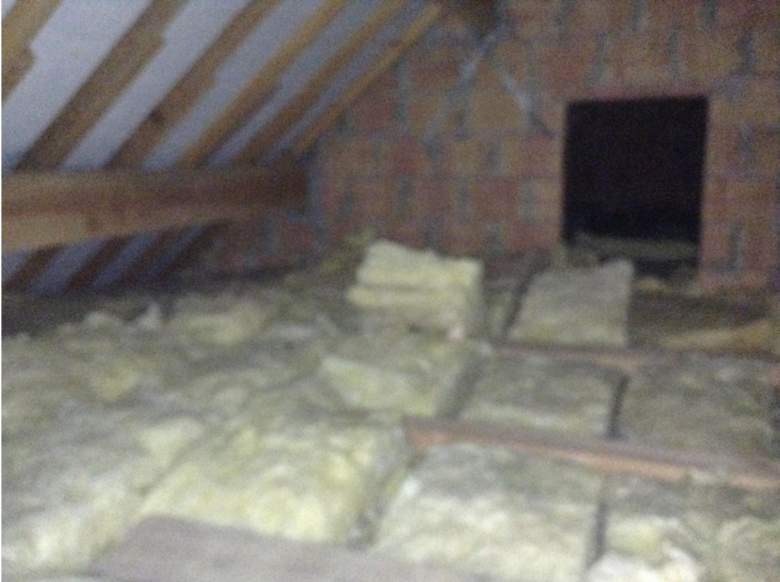
Figure 41 - Pose de l'isolant entre les chambres et les combles – Photo réalisée par l'habitant
