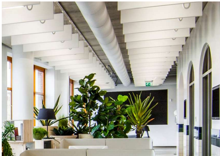
Figure 10 : Absorbants acoustiques en éléments suspendus, (rockfon.com)
