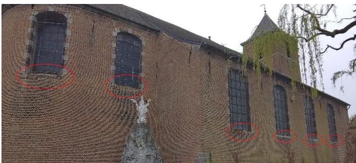
Figure 14 : Traces de rouille sur les grilles protégeant les vitraux du cœur
