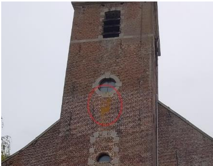
Figure 12 : Dégradation sous l'œil de bœuf du clocher
