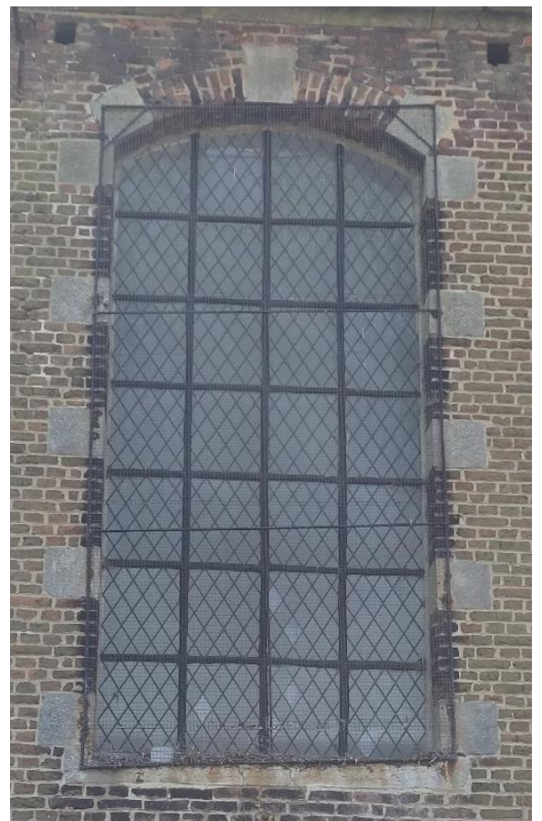
Figure 13 : Traces de rouille sur les vitraux des bas-côtés
