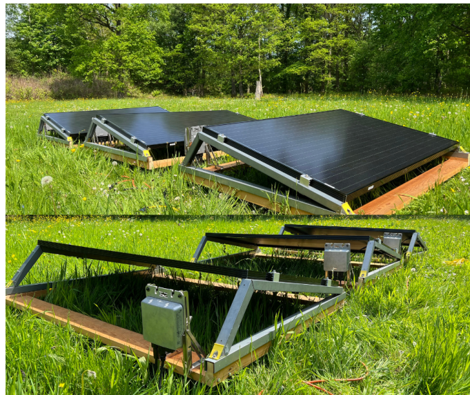
FIGURE 4.7 – Supports, micro-onduleurs et Panneaux solaires
