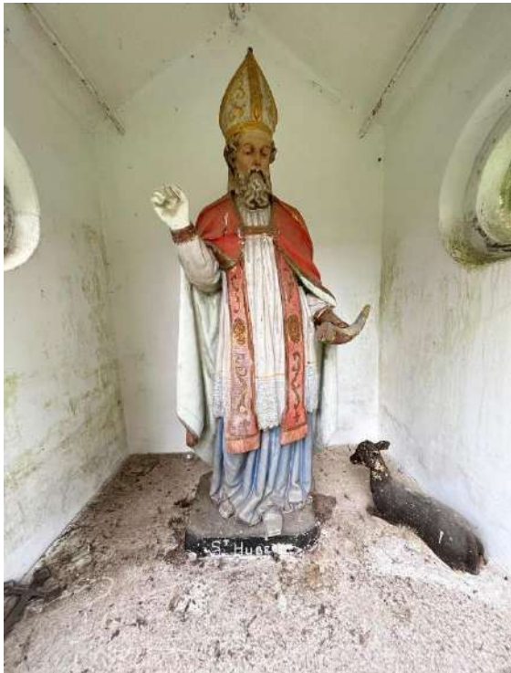
Figure 107: statue de Saint-Hubert. On distingue les tirants dont les ancrs sont visibles à l'extérieur. Louise Schröder, 18 octobre 2022.
