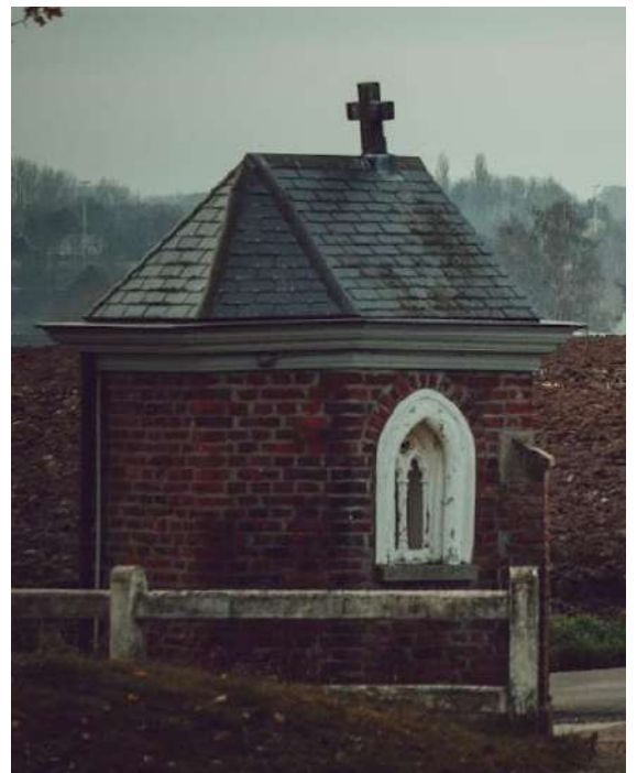
Figure 129: état en 2020. On remarque la peinture écaillée sur le remplage de la baie latérale. Les corniches sont déjà grises. Google Earth, juillet 2023.
