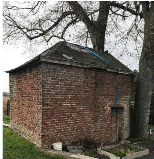
Figure 50: état de l'édifice après une tempête en 2022. Façade arrière et gauche. On observe la porte en bois à linteau droit sur la façade gauche. On distingue également le matériau de toiture. Sarah Aniciato, 2022.
