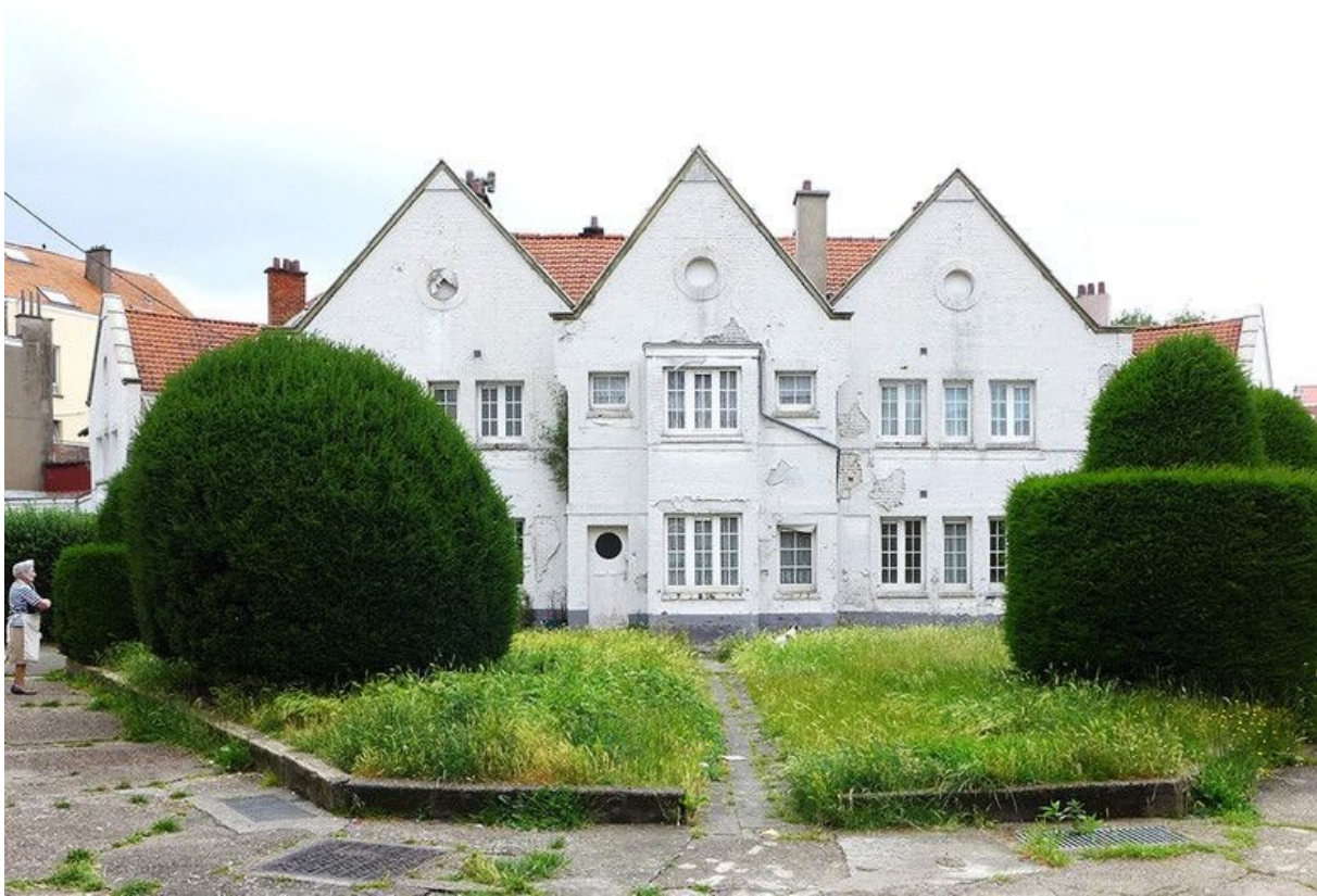
fig. 17 Etat de la façade avant rénovation (Marc Detiffe)
