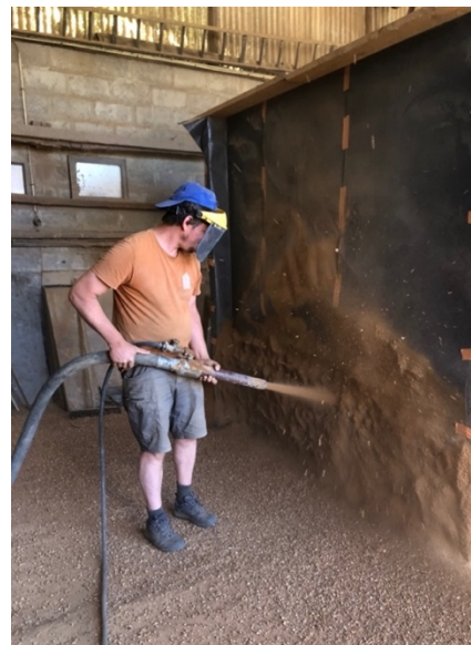
Figure 3.33 : Pied du mur encombré par le rebond
