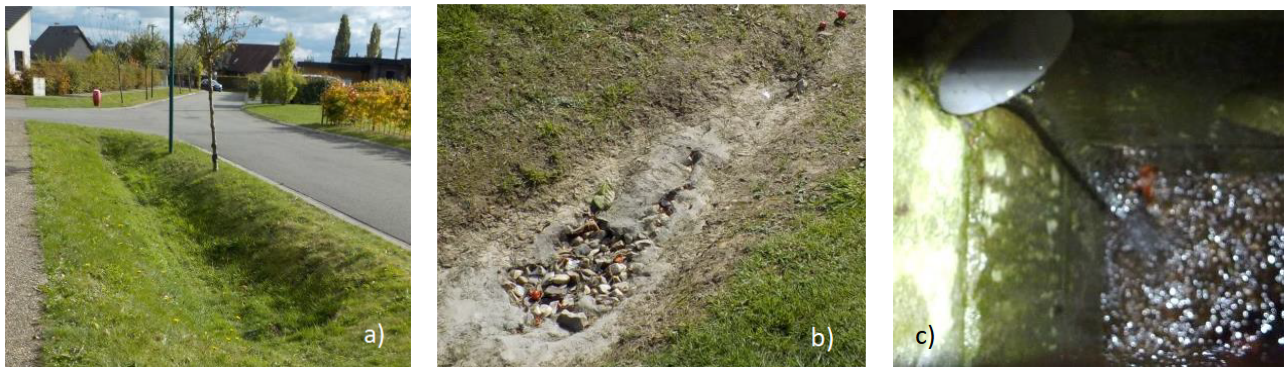
FIGURE 1.3 – a) Noue drainée – b) Massif drainant affleurant sous géotextile déchiré – c) Rejet des eaux issues des massifs drainants dans un regard en aval (Ledun et al. , 2018).
