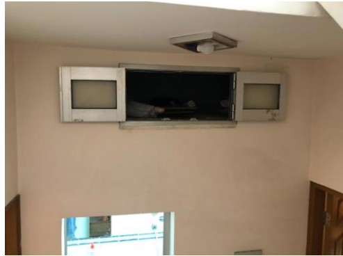
Figure 38 : Photo d'un rangement intégré dans le mur de la maison de Mme Pham
