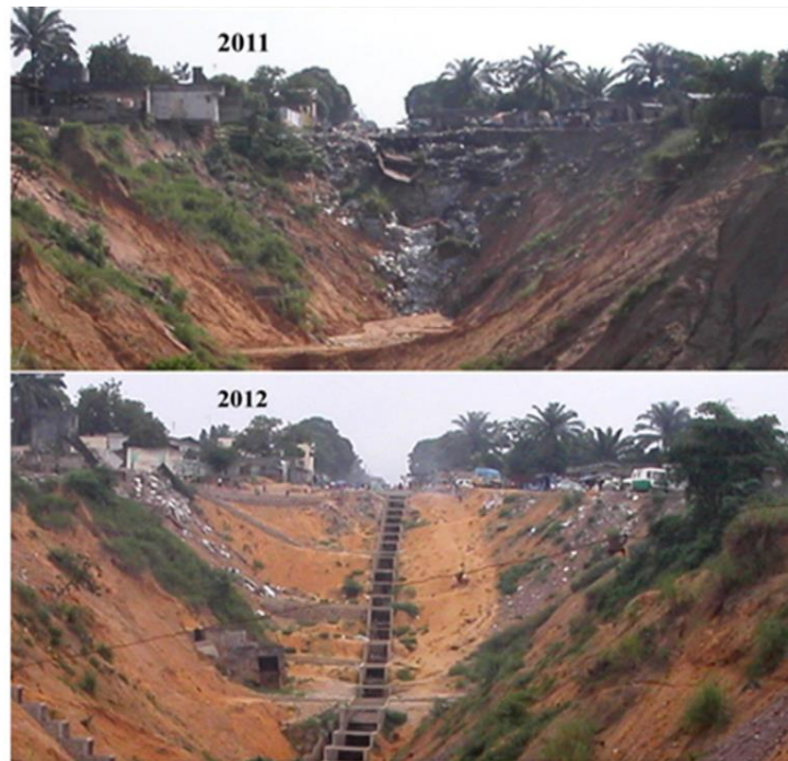
Figure 12. Mesures prises en 2011 et 2012 à la tête du méga ravin de Laloux. En 2011 on peut y voir qu'un nombre insuffisant de sacs de sables ont été placé à la tête du ravin. En 2012 une construction plus pérenne a été construite : un escalier qui agit comme une gouttière (Makanzu Imwangana et al. , 2014)
