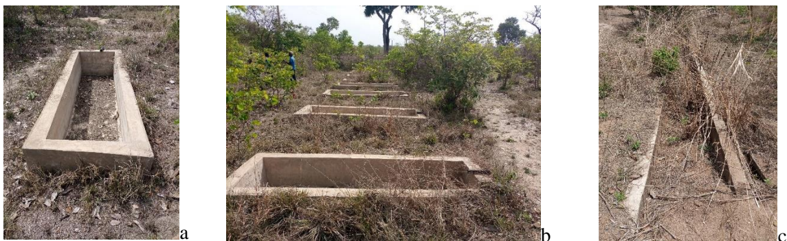
Annexe 6. Etat des abreuvoirs des barrages d'Alafiarou (a,b) et de Babarou (c) dans l'arrondissement d'Alafiarou dans la commune de Tchaourou
