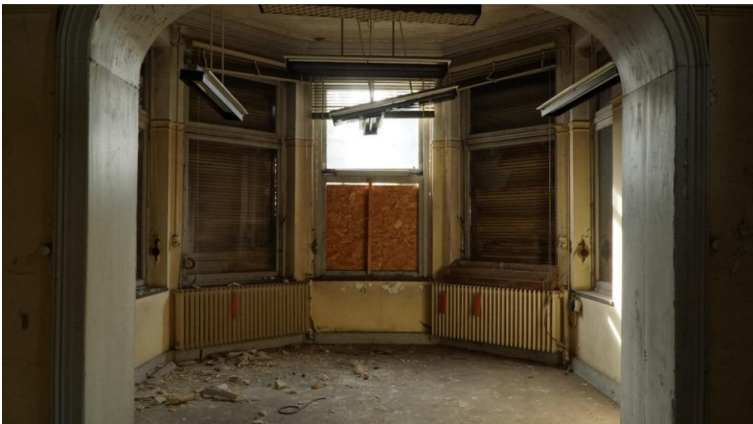
Ancien bureau dans lequel se mélangent morceaux de plafond et vitres cassées. ©Nicolas Gobiet
