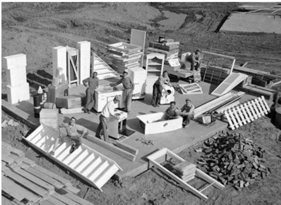
Figure 42 : des travailleurs pris en photo lors de la construction d'une maison à Levittown à New York en train de poser des objets préfabriqués tels que les châssis des fenêtres, les escaliers, les meubles, les murs.
