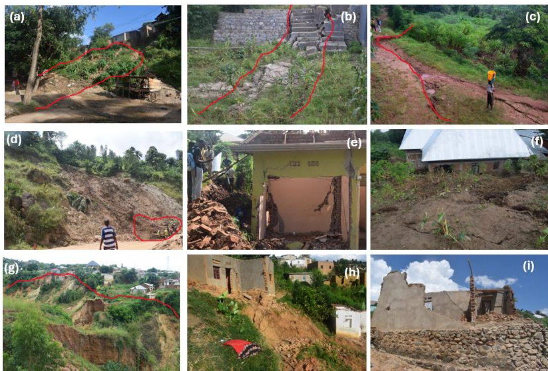
Figure 25. Impacts sur les infrastructures de base situées dans la partie amont des rivières Ntakangwa et Kanyosha
