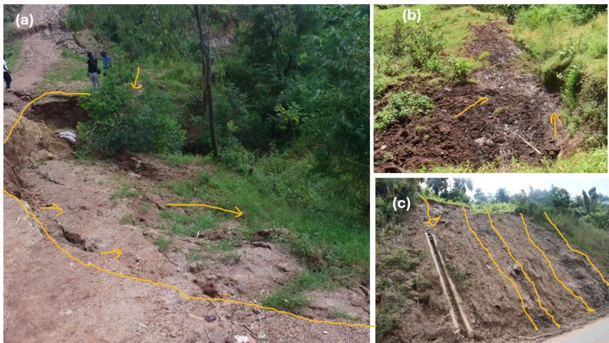
Figure 20. Exemples des types des processus conduisant à des glissements de terrain réencensés dans la zone d'étude. (a). Glissements de terrain du type rotational slide, récent et actif et observé à Sororezo. (b). Glissement de terrain du type debris flow actif sur des sols argileux saturés en eau (mai, 2024, vers RN7 abandonnée). (c). Glissement de terrain du type translational slide actif observé sur le versant de la RN7 actuelle. Affecté par un double drainage naturel actif et un drainage anthropique (observé en avril 2024).
