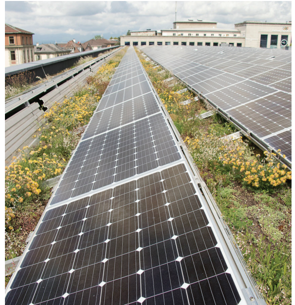
Figure n°4 : Photographie du toit biosolaire du Palais de Beaulieu à Lausanne. Auteur : (Aino Adriaens, 2015).
