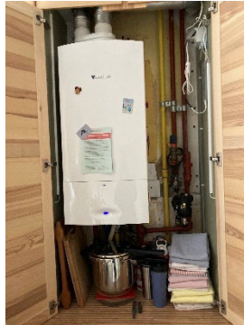
Figure 69: Chaudière de l'habitation dissimulée dans un meuble de cuisine- photo R.Fransolet
