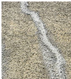
Figure 70: Fissure réparée sur la façade – photo R.Fransolet
