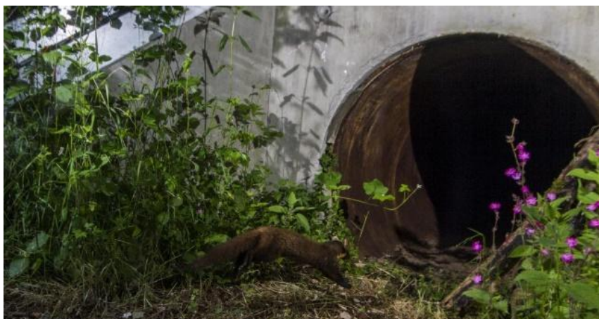
Figure 58 : Exemple d'un passage pour la petite faune © vinci autoroutes
