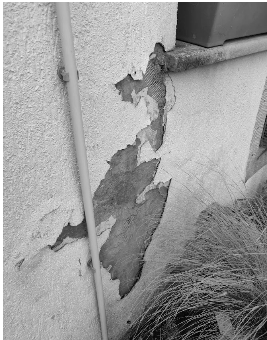
ill53 Photographie de la détérioration du revêtement en crépi de la façade arrière de la deuxième annexe (Réalisation personnelle, 2024).
