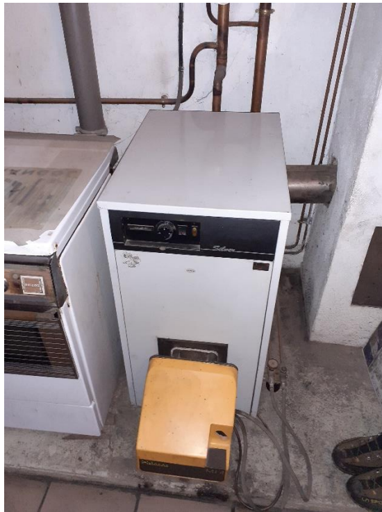
Figure 37 - Photo de la chaudière au fioul de M. et Mme G. - réalisée par mes soins
