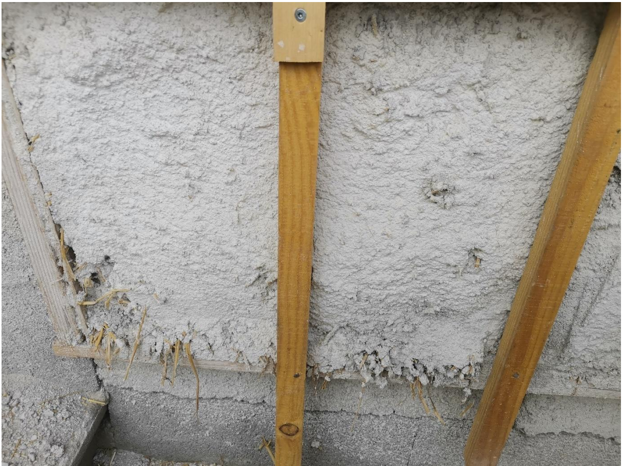
Figure 50 - Photos de la maison en cours de travaux (bottes de paille enduites et bardage bois) - réalisées par mes soins
