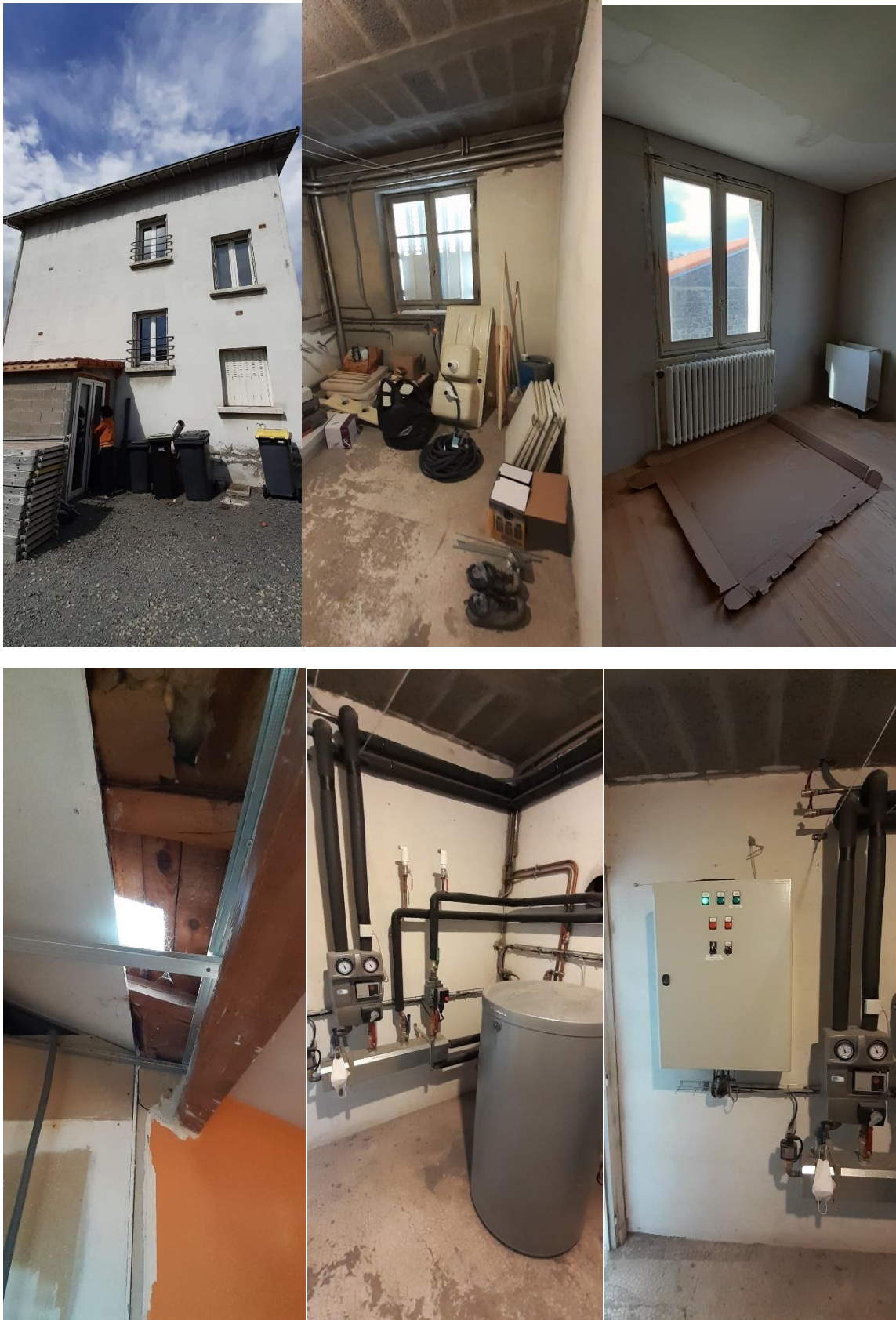
Figure 49 - Photos de différents éléments de la maison avant travaux - réalisées par le technicien SOLIHA
