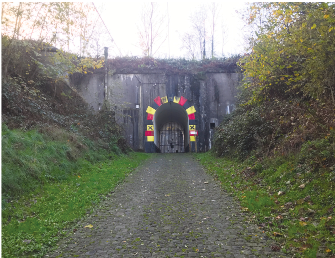
Figure 25 : Photo personnelle montrant la rampe d'accès ascendante du fort de Embourg, novembre 2022
