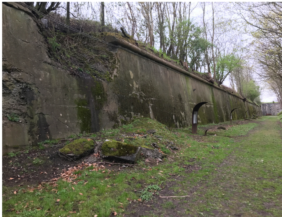
Figure 17 : Photo personnelle montrant des dégâts de bombardements dans le béton du fossé ouest du fort de Loncin, avril 2022
