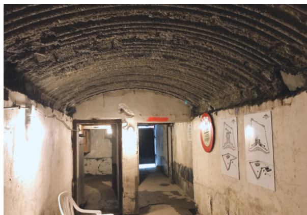
Figure 15 : Photo personnelle montrant un coffrage dont la tôle ondulée a été pillée au fort de Flémalle, septembre 2022
