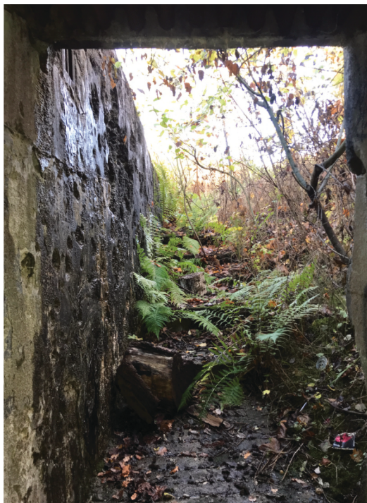
Figure 16 : Photo personnelle montrant des impacts à la sortie du débouché infanterie du fort d'Embourg, novembre 2022
