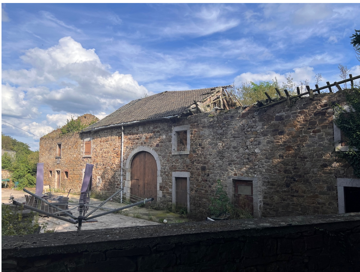
Figure 120 : illustration d'un mur dans un état de dégradation avancée d'une ferme à cour à Sasserotte— Illustration © Antoine GUSBIN
