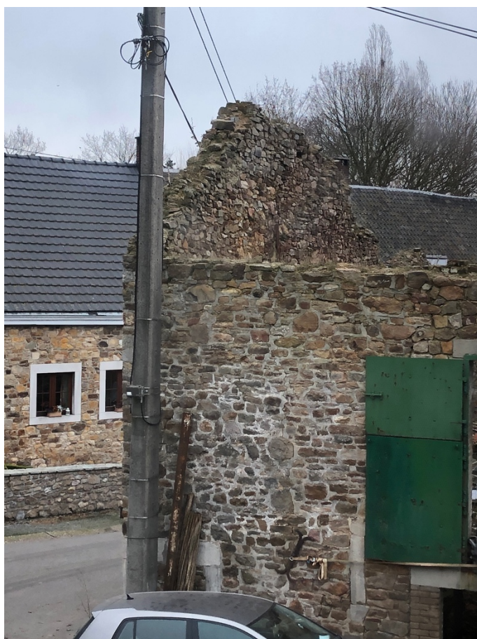
Figure 119 : illustration d'un mur dans un état de dégradation avancée d'un bâtiment agricole à Fays – Illustration © Antoine GUSBIN
