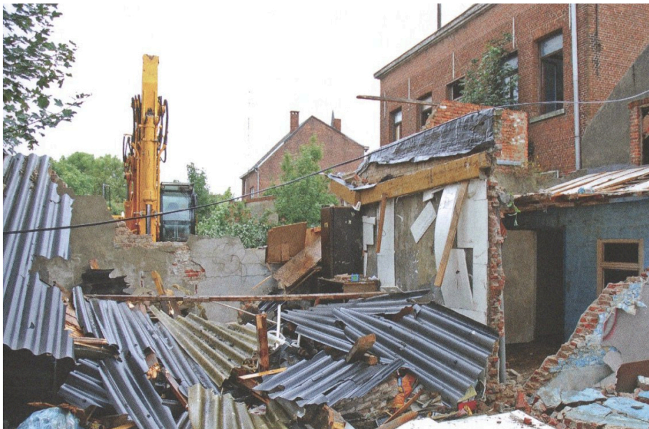
Fig. 13 : Démolition dans le centre de Doel. Source : Creve, J. (2019). Doel 2020: Het gevecht om Doel en de polder , p.55.
