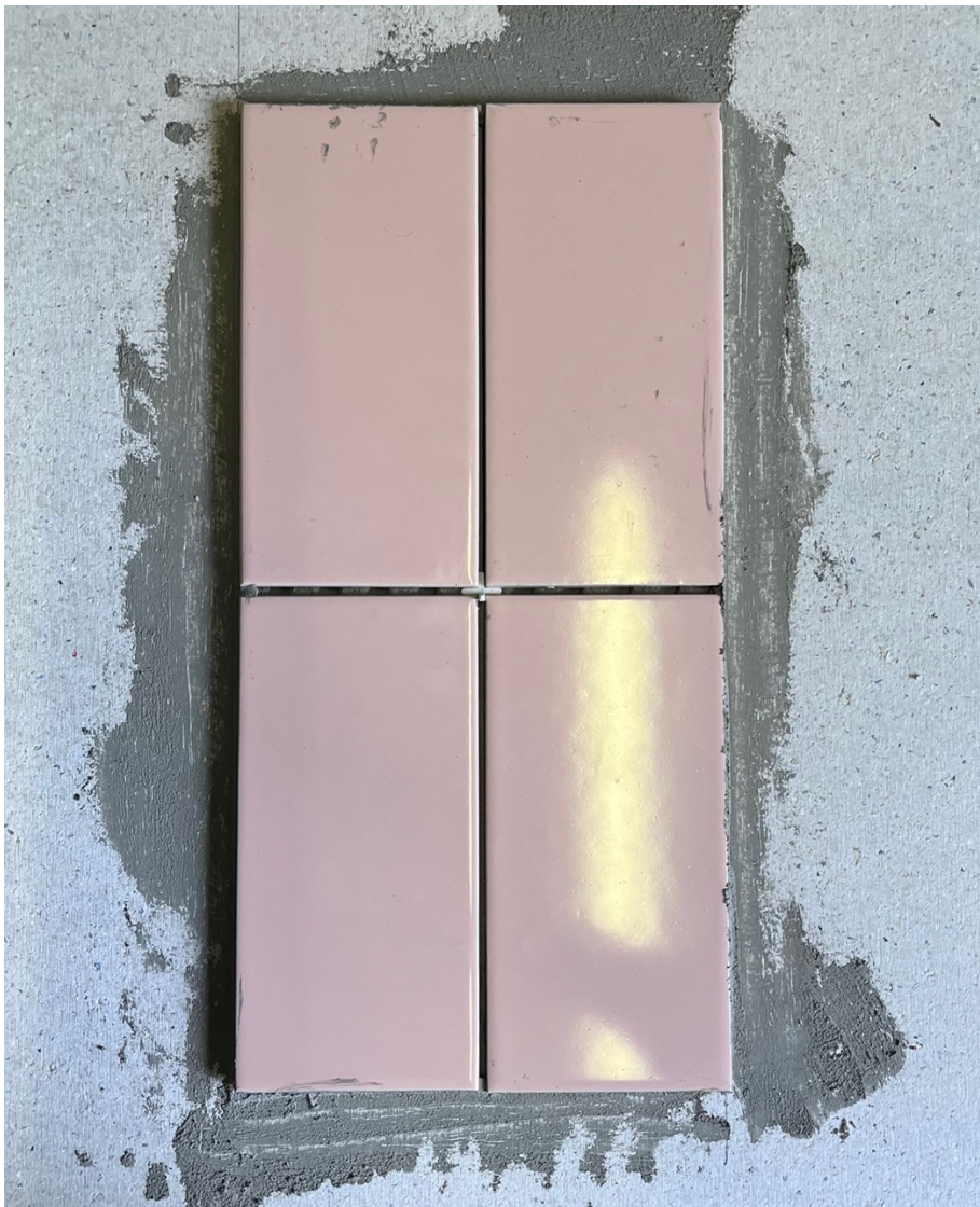
Photo des carreaux mis en œuvre avec du mortier-colle Kérakoll Bio souple
