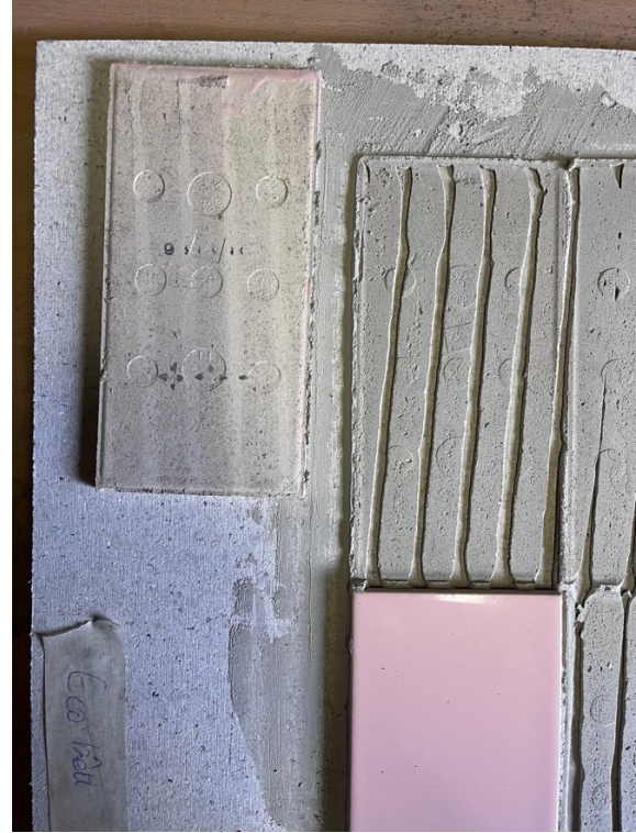
Zoom - État d'un des carreaux posé avec Écobâti, après démontage
