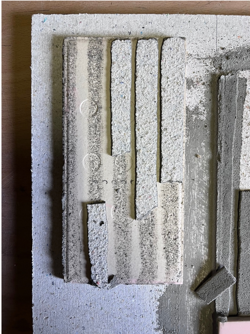
Photo état d'un des carreaux, après démontage
