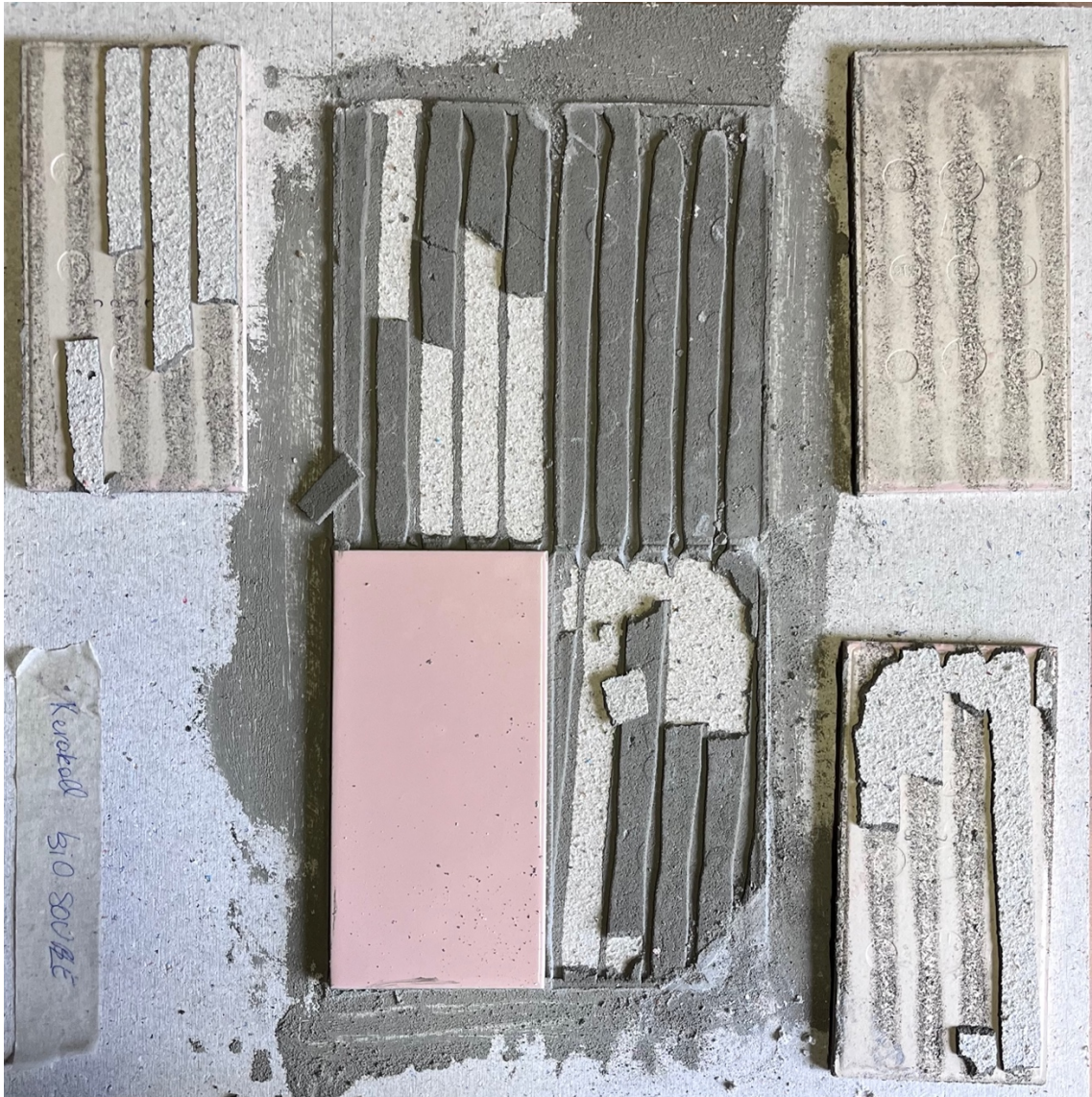
Photo état des carreaux et du mortier-bâtard, après démontage
