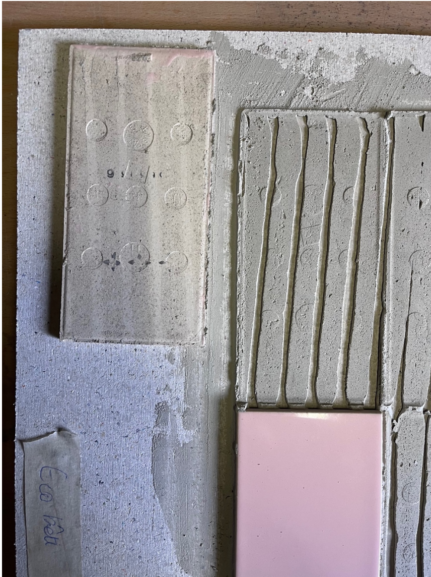
Photo état d'un des carreaux, après démontage
