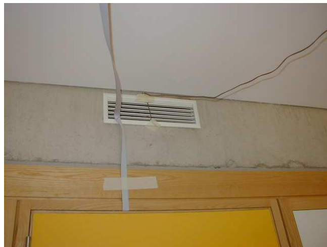
FIGURE 3-8: GRILLE D'EXTRACTION DANS LE MUR ENTRE UN BUREAU ET LE COULOIR 16
