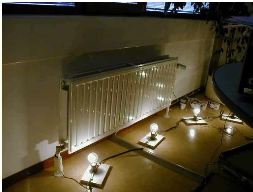
FIGURE 3-1: RADIATEUR PRESENT DANS UN BUREAU 10
