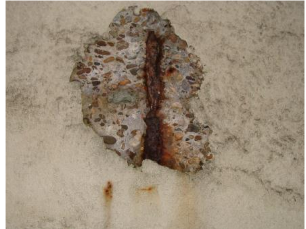
Figure 51 : Exemple de fissure par carbonatation (Courard, 2011)
