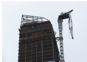
Ruine d'une grue après une tempête à New-York [craneaccidents.com, 2012].
