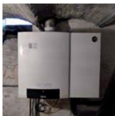
Chaudière gaz à condensation.
