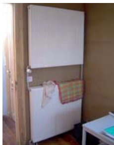
Radiateurs surdimensionnés, à basse température.
