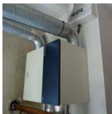
Ventilation double flux avec échangeur de chaleur.
