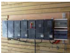
Compteurs d'électricité pour chaque logement.
