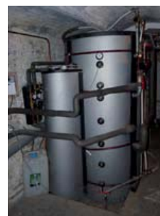
Ballons de préparation de l'eau chaude sanitaire.
