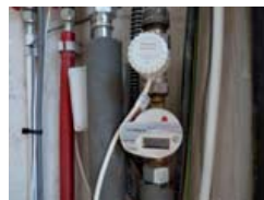
Compteurs intégrateurs pour les consommations de chauffage de chaque logement.
